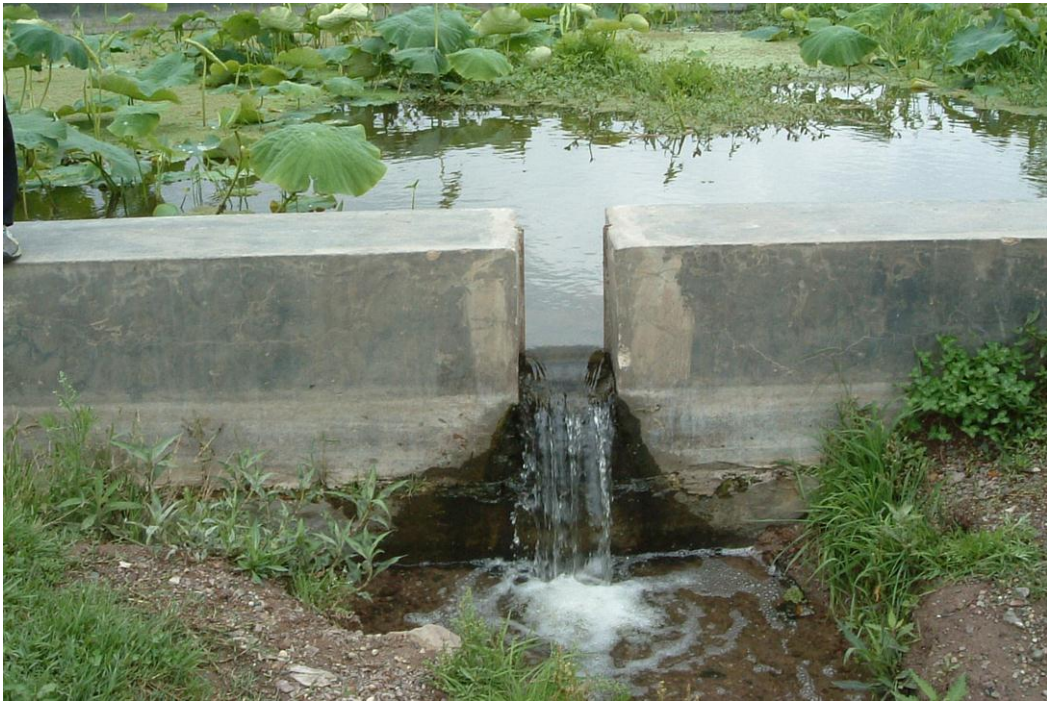
人工湿地的出水
