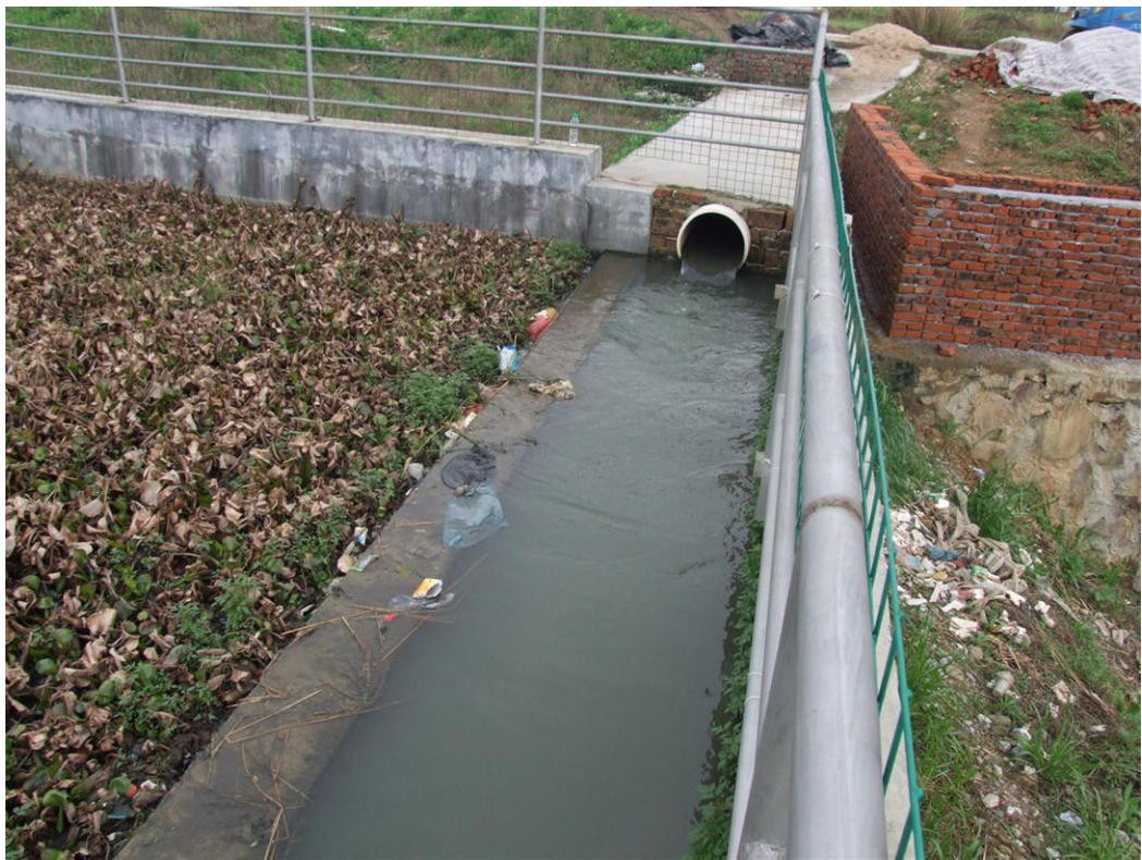
湿地进水口及配水渠
