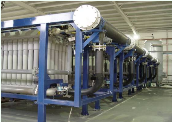
微滤膜处理装置
