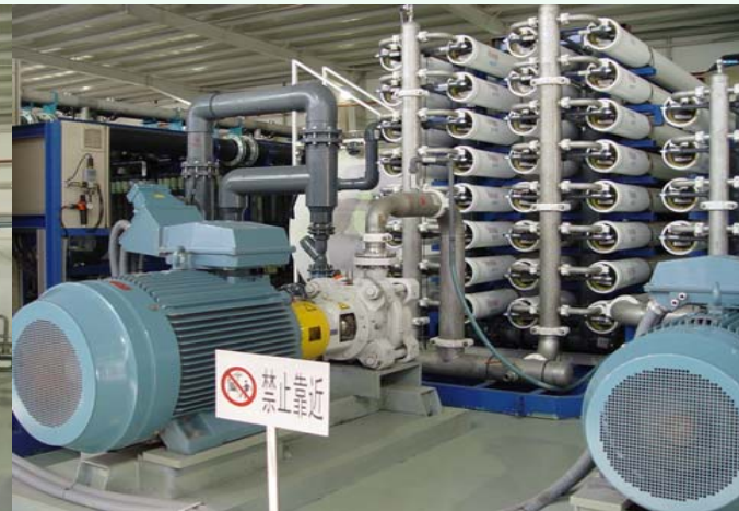
反渗透处理装置
