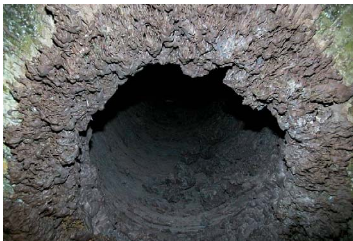
图 1 灰渣焚烧炉焚烧复杂物料结焦现状
