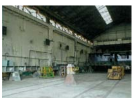
涂装车间的排气扇 (墙壁)
