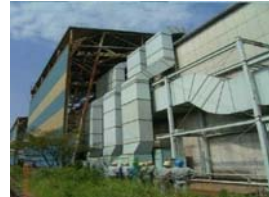
喷涂车间的排气筒
