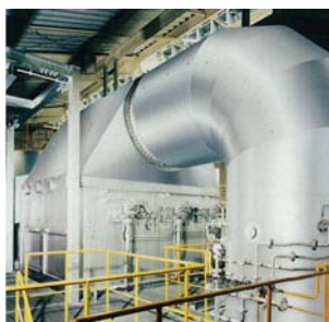
↑ 脱硝反应塔外观 (一部分)
