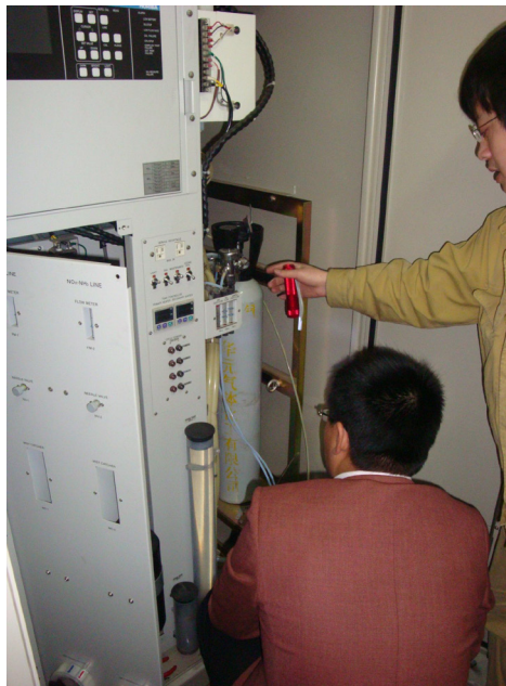
图4 中国某火力发电厂脱硝设备出口处的 NH 3 逃逸率监测装置
