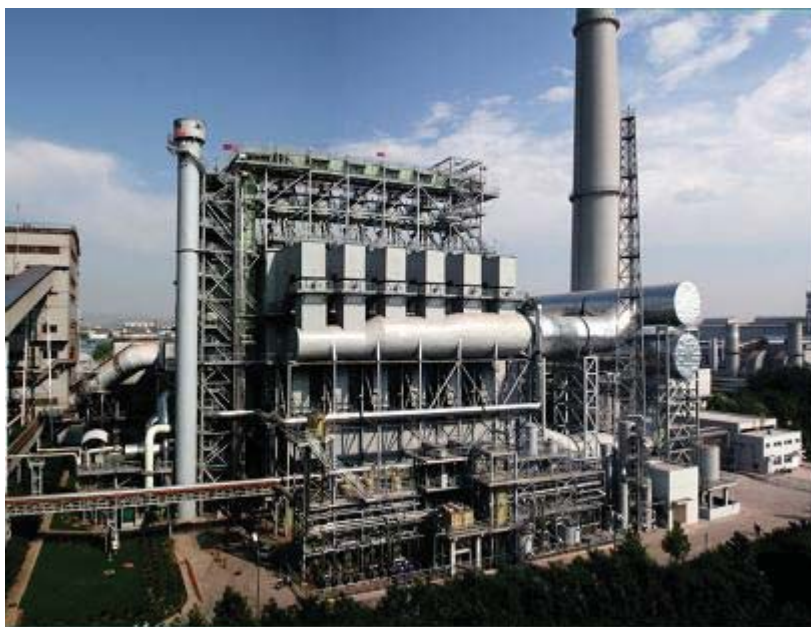
照片 1 干法脱硫脱硝装置全景
