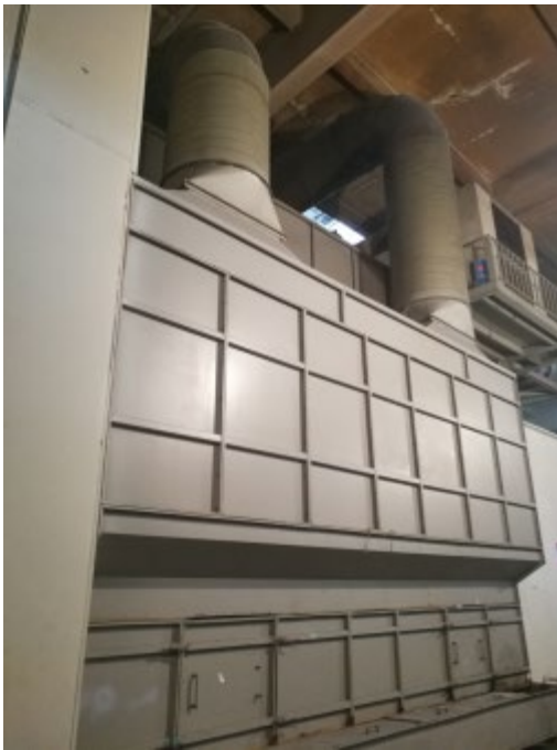
密闭喷漆房废气收集系统
