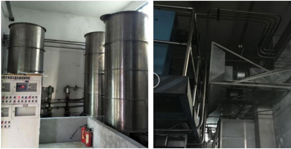
图 2.2-1 20#企业油墨储存及自动供墨系统 (a) 和自动供墨管道 (b)
