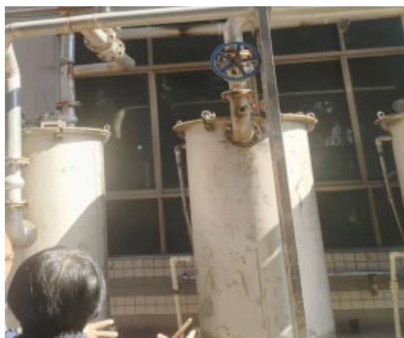
图 2.3-8 真空泵系统第二级除油罐
