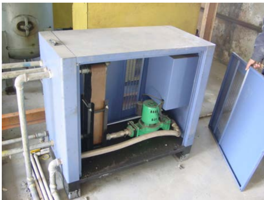
空压机余热回用系统
