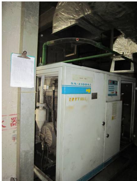
空压机余热回收装置
