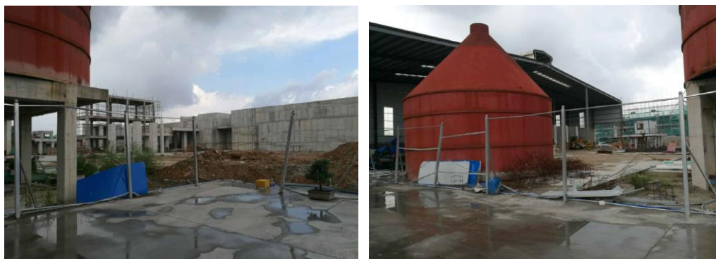
图 3.6-16 广东新瑞龙生态建材有限公司花都建筑垃圾循环综合利用厂 A 区选址实拍图
