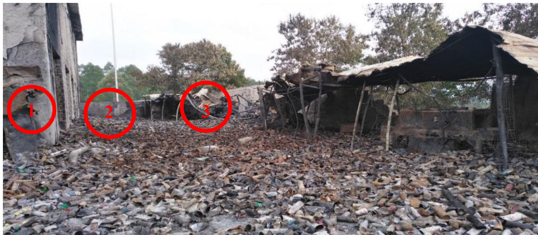
图 7 火灾后事故现场照片 (1-丙类仓库 B3; 2-戳罐作业区; 3-过膜作业区)
