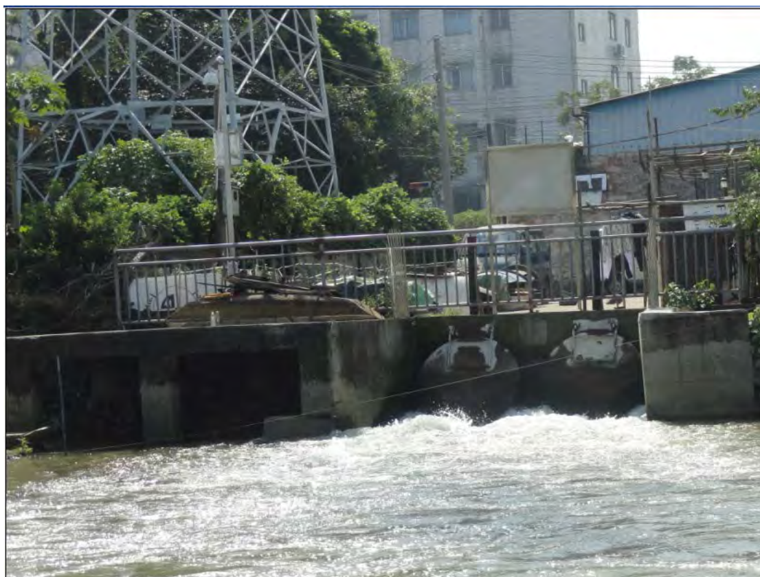
图 3-1 东都污水处理厂排水口
