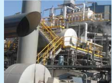
图 2：位于澳大利必和必拓公司（BHP Billiton）West Cliff Colliery 煤矿的 VAM 发电厂
