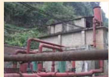
图 3：Songzao 煤矿采煤区的泵站
