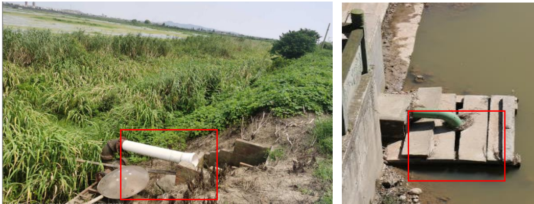
图 11 灌溉泵站、养殖等取水口（取水设施）
