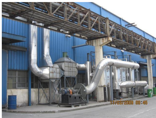
图 3-4 再生式颗粒活性炭吸附装置在集装箱厂固化废气中应用
