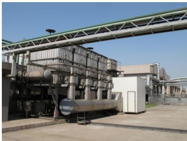
图 3-10 某特种压敏胶干燥废气活性炭纤维吸附装置应用
