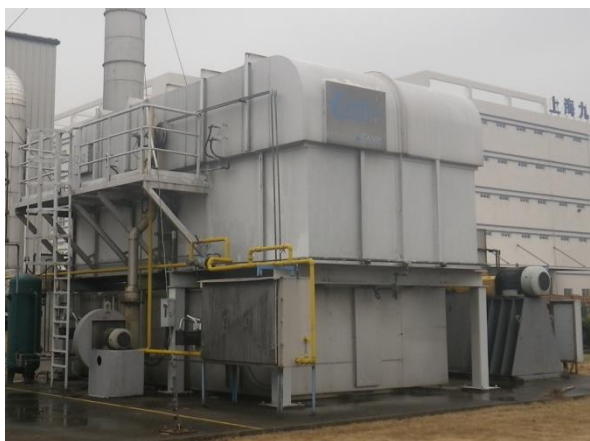
图 3-9 某杂志印刷厂 RTO 应用
