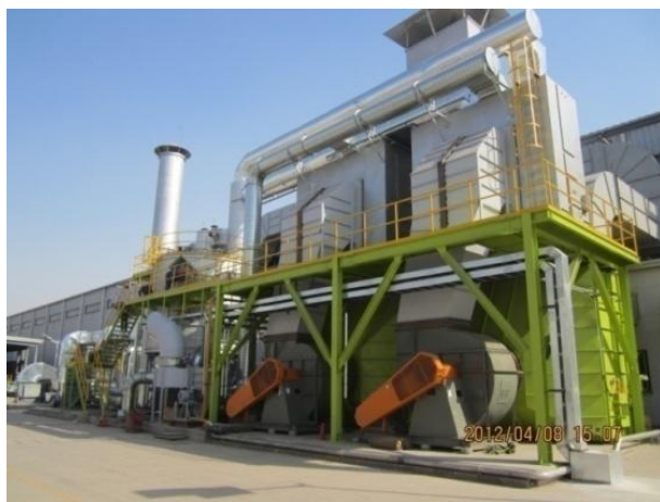
图 3-3 沸石转轮吸附装置在工程机械喷涂废气处理中应用
