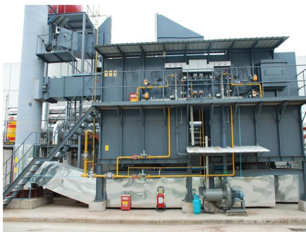
图 3-11 某胶粘带烘干废气蓄热式热氧化炉应用
