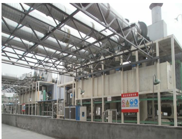
图 3-8 某彩印厂干复废气溶剂回收应用
