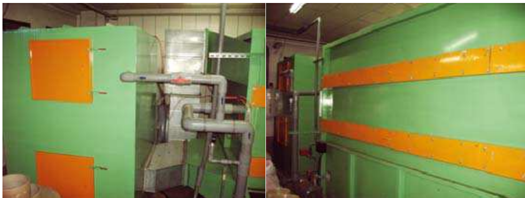
圖 4 觸媒處理塔(核定處理效率 80%)
