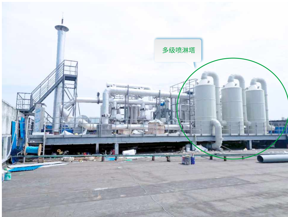
“水洗+碱洗”组合系统
