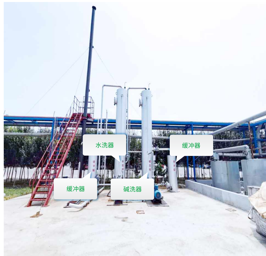
储罐废气处理设备
