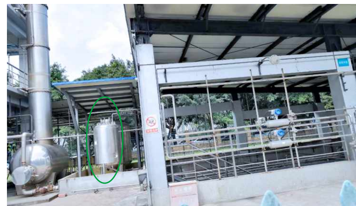
液态VOCs物料缓冲罐
