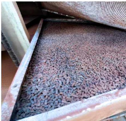
❌ 未紧密充填活性炭, 废气通过缝隙直排 (违法)
