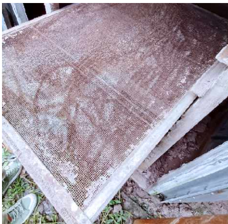
❌ 活性炭长期未更换, 已经积灰、发白失效 (违法)
