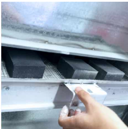
❌ 活性炭表面被覆盖, 已经失效 (违法)
