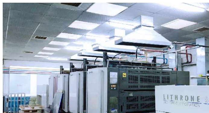
✅ 印刷机在密闭车间内,且安装废气收集设施
