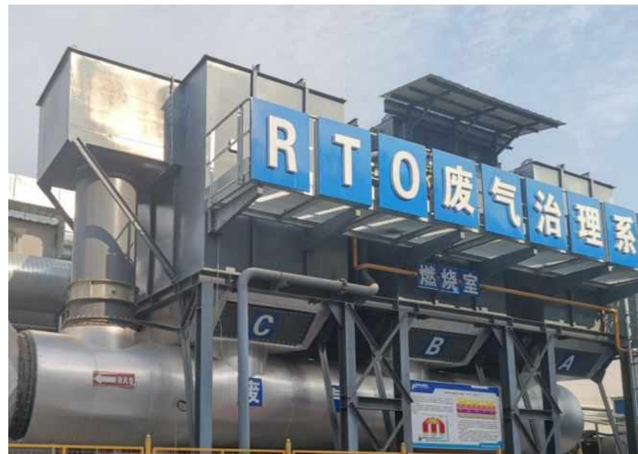
蓄热燃烧设备
