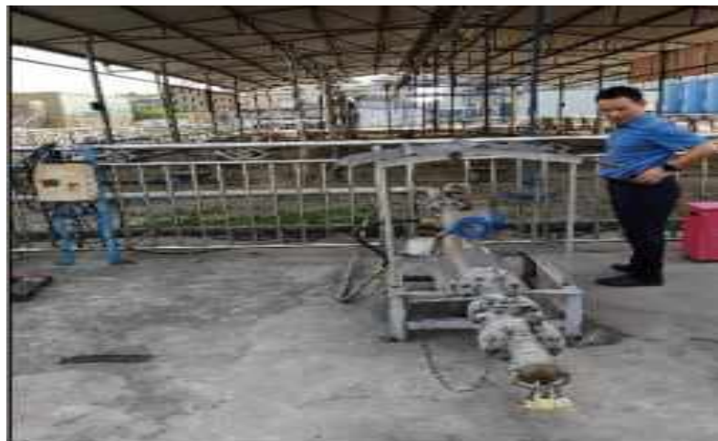
✔ 液态VOCs物料卸载管道
