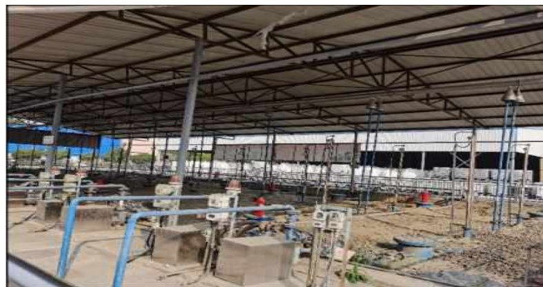
✔ 液态VOCs物料卸载管道
