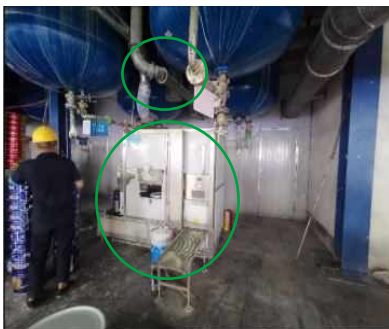
✅ 密闭式自动包装,且安装废气收集设备
