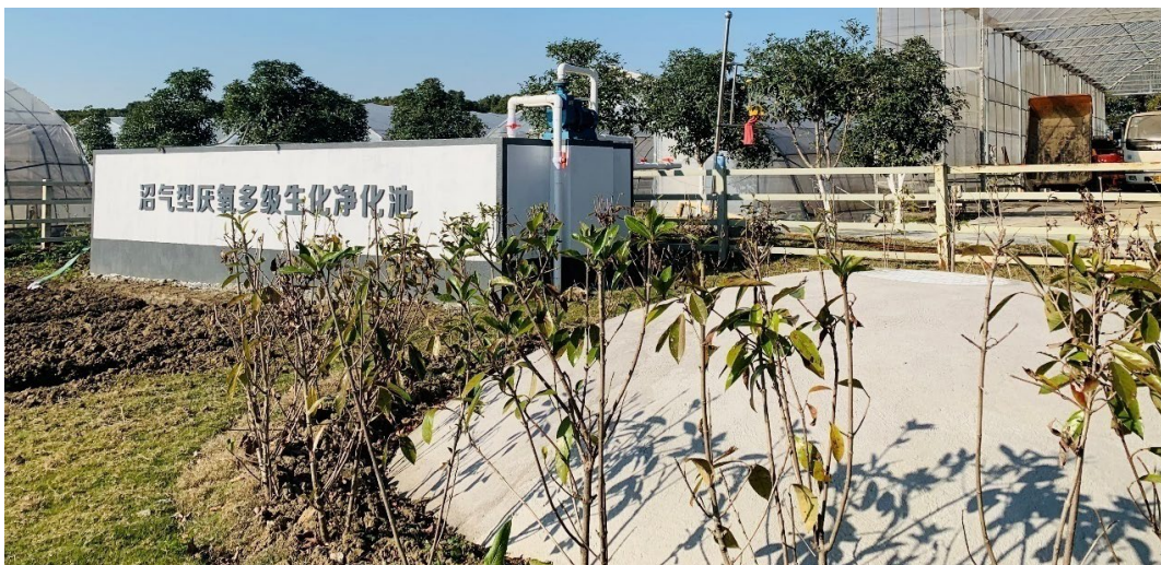
图 2-22 沼气型厌氧多级生化净化池
