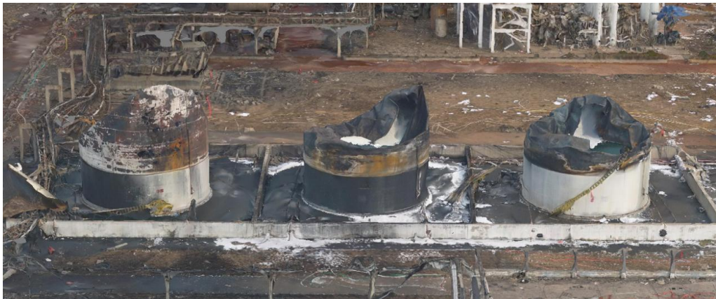
图10 天嘉宜公司受爆炸冲击起火燃烧后的苯和甲醇储罐
