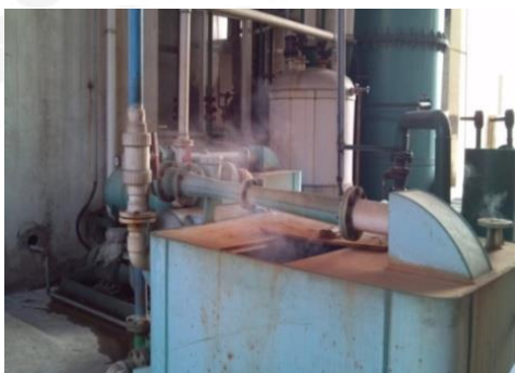
水真空泵尾气未收集
