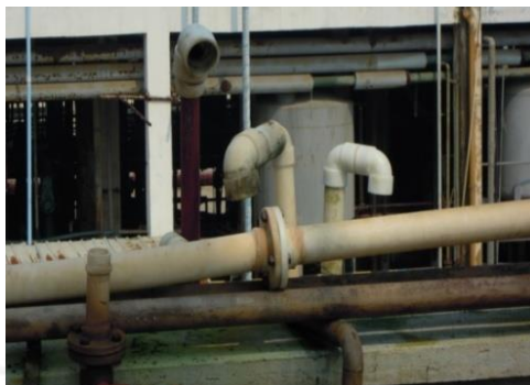
废气收集管线泄露
