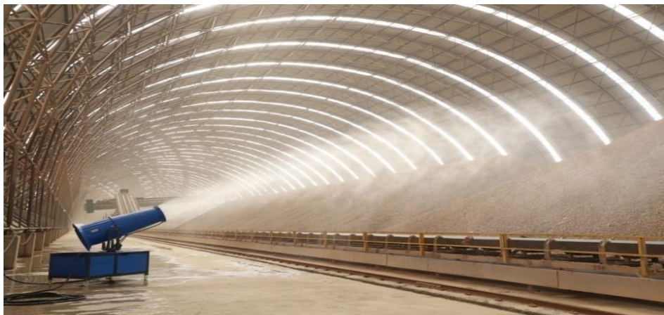
石灰石物料大棚不间断喷淋防尘
