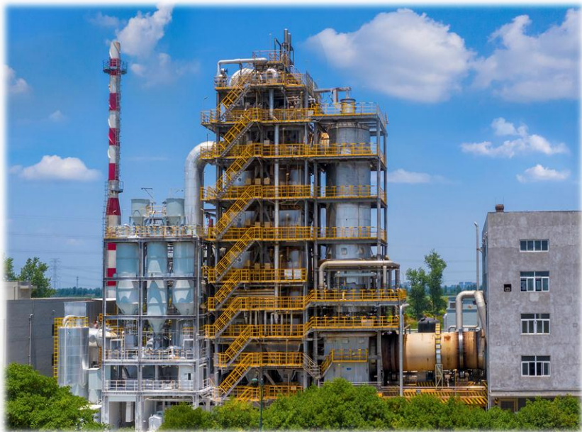
新和成三废焚烧炉
